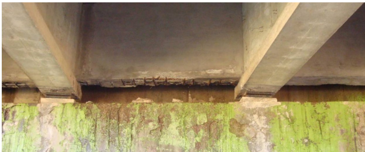
Figura 84 – Degrado intradosso traversi
