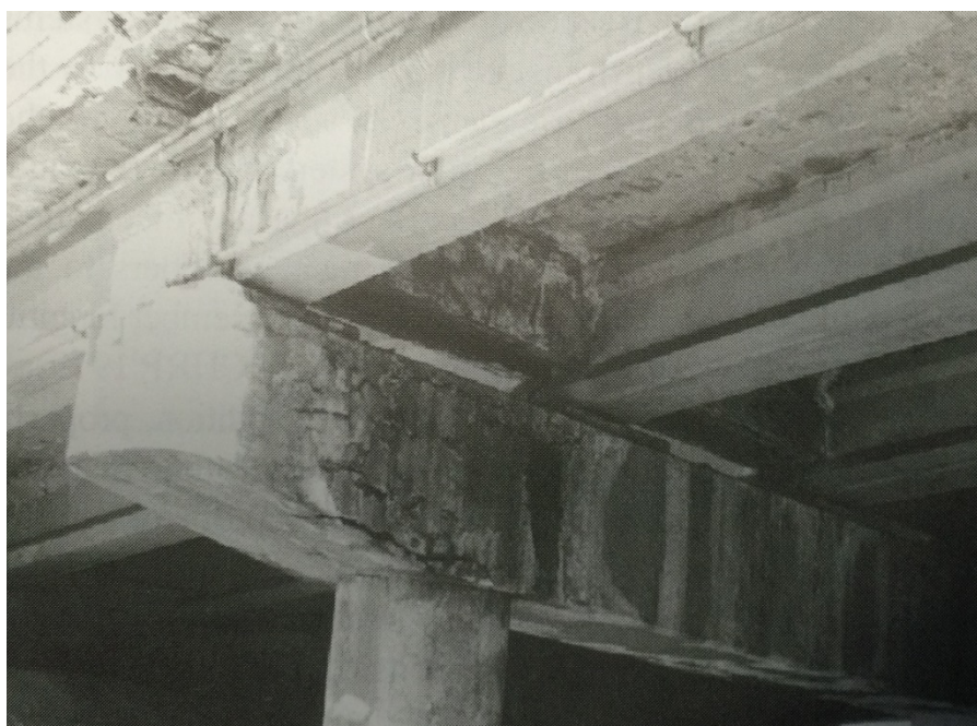
Figura 104 - Degrado del pulvino a causa delle infiltrazioni
