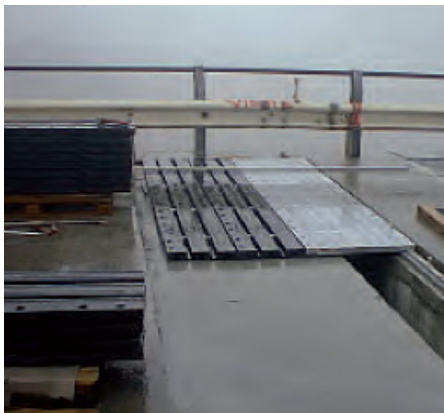
Figura 98 - Giunto a piastra ponte
