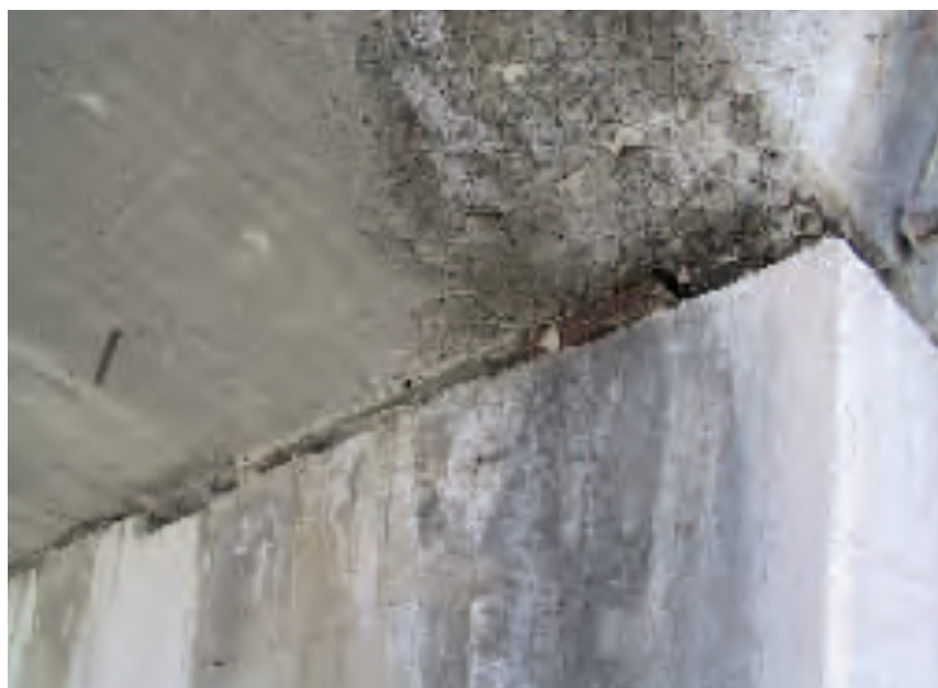
Figura 105 - Degrado giunto su pila ed appoggio
