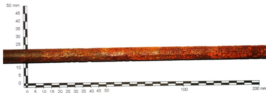
Figura 51 – Esempio di corrosione generalizzata
