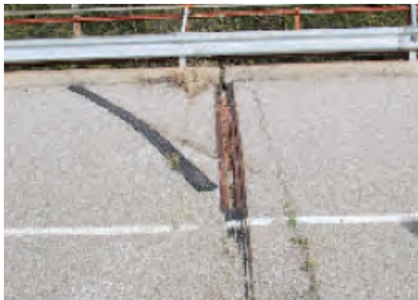
Figura 102 - Ammaloramento del giunto
